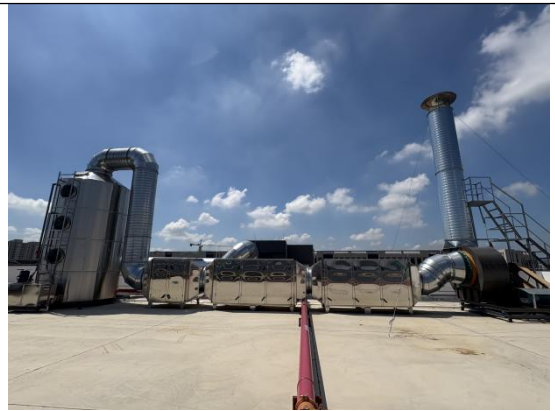
注塑废气处理设施(水喷淋+干式过滤+两级活性炭吸附装置)
