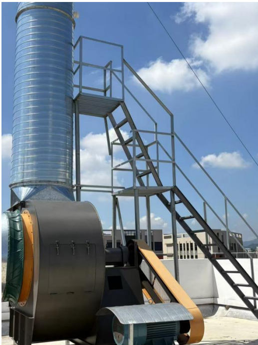
废气采样平台
